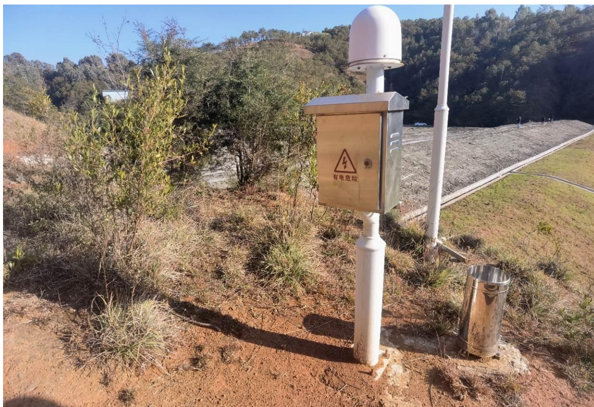
图 2-14 库区周边在线位移监测、雨量监测
